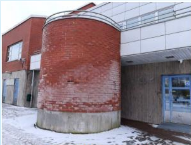
Kuva 26. Kierreportaikon tiilimuurauksessa havaittiin jäätymisen aiheuttamaa muurauslaastin ja tiilien rapautumista ja irtoamista.
