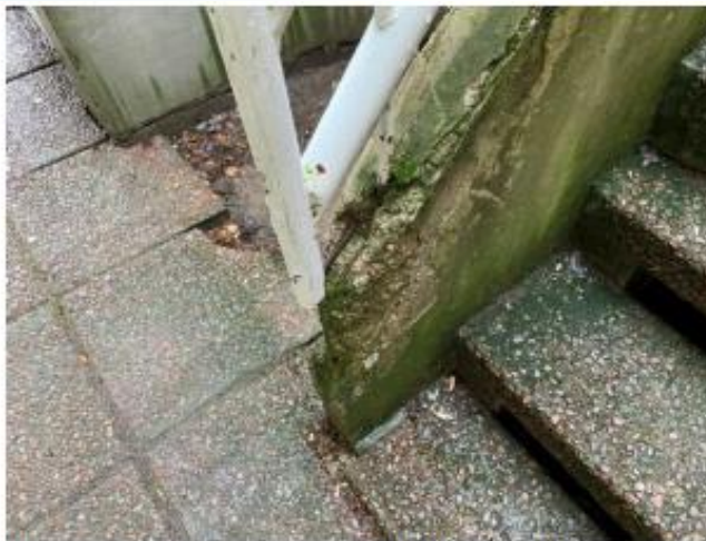
Kuva 27. Kierreportaikon betonirakenteissa havaittiin teräskorroosion aiheuttamia vaurioita.
