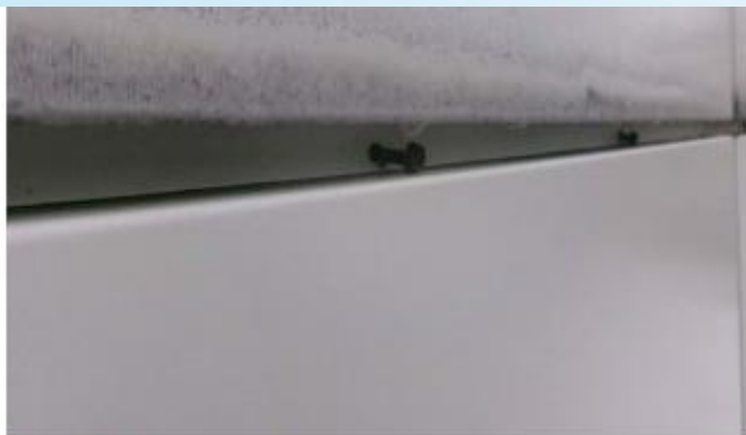
Kuva 15. Julkisivun peltikasettien kiinnitysruuvit ovat ruostuneet ja löysällä.
