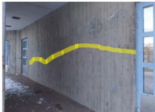
Kuva 21. Kuvassa vaakasuuntaista halkeama, jonka pituus noin 6,5 metriä.
