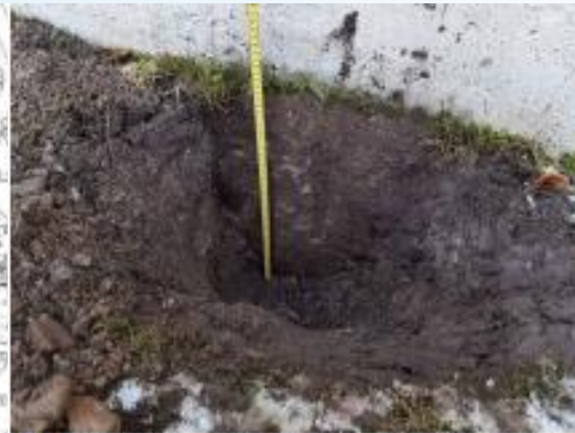
Kuva 14. Tilan 066 edessä vierustäytössä on 20 cm kerros pintamaata ja savaa, 30 cm hienoa sorsaa, hiesua ja isoja kiviä. Seinän pinta on betonia, vedeneristystä ei ole.
