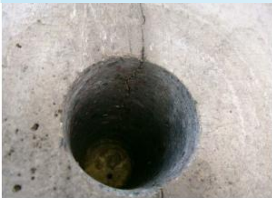
Kuva 20. Halkeama ulottuu rakenteen läpi.
