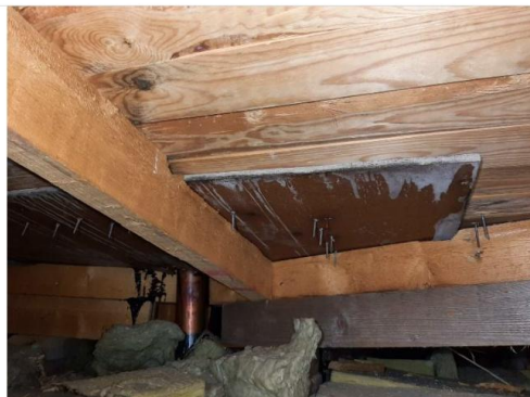
Kuva 129. Sadevesikaivon/-putken ympärillä kattorakennetta on vahvistettu levyllä. Levyssä on silmännähtävää mikrobikasvua.
