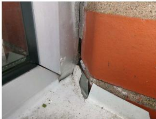
Kuva 32. Ikkuna pellityksissä epätiiviyyksiä.
