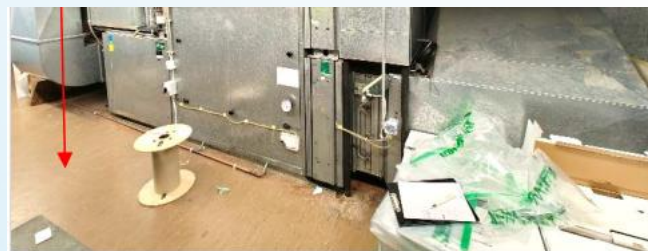
Kuva 33. IV-konehuoneen 202 ruskea muovimatto sisältää DEHP-yhdistettä. (HA16)
