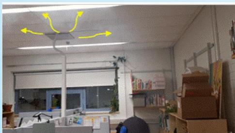
Kuva 96. Ilman jakautuminen tilassa 066. Keltaiset nuolet kuvaavat karkeasti ilman suuntaa. Tilan poistoventtiilit kuvanottokohdan suunnassa. Ilma ei jakaudu ikkunoiden viereisiin työpisteisiin 5 minuutin tarkastelun aikana.
