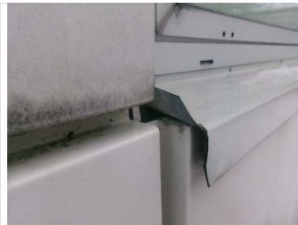
Kuva 33. Julkisivun peltikasettien ja ikkunapeltien pellityksessä epätiiviyyksiä.
