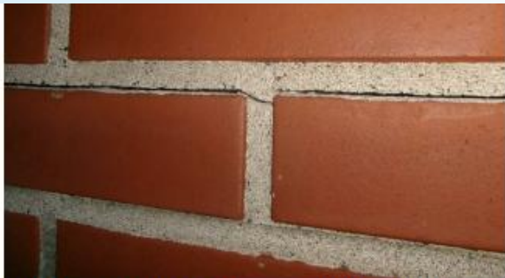
Kuva 11. Tiili ja muurauslaasti on irronnut toisistaan.
