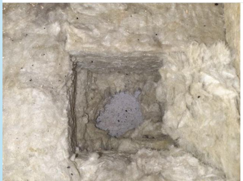
Kuva 128. YP1, eristekerroksen ja betonilaatan välissä ei ole höyrynsulkua.
