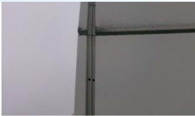
Kuva 16. Julkisivun peltikasettien kiinnitysruuvit irronneet.
