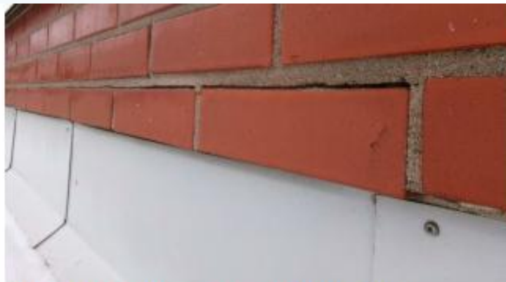
Kuva 12. Tiili ja muurauslaasti on irronnut toisistaan.
